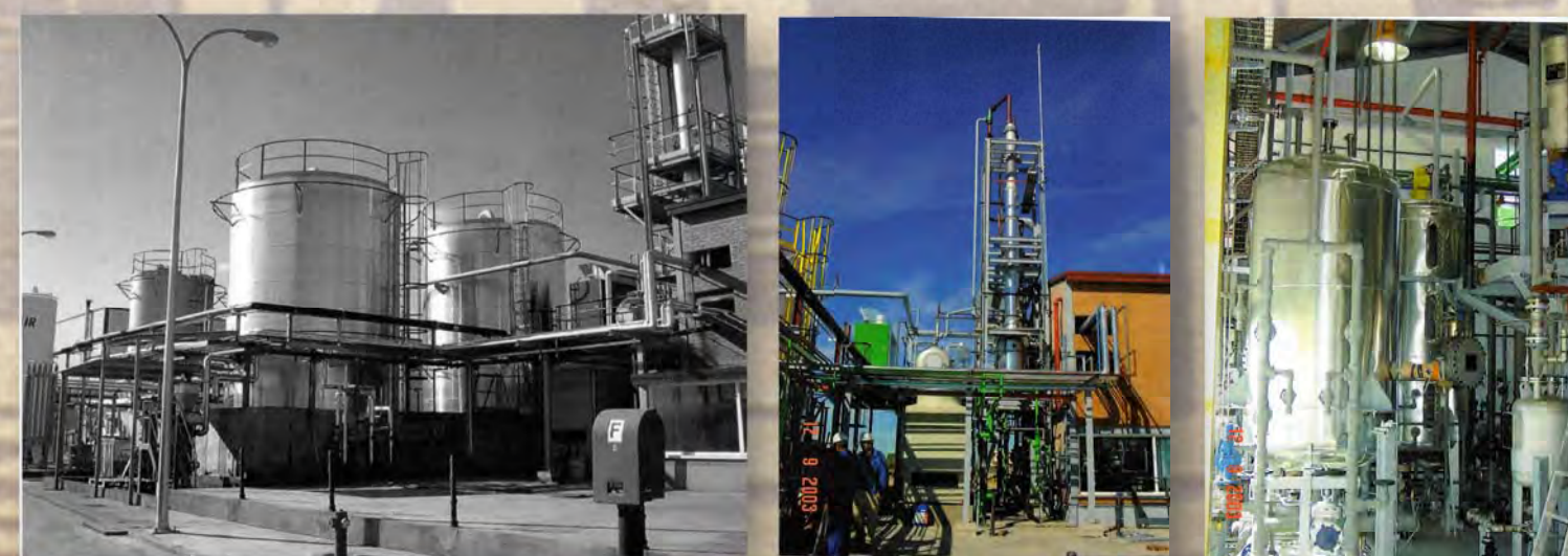
Planta de biodiesel
