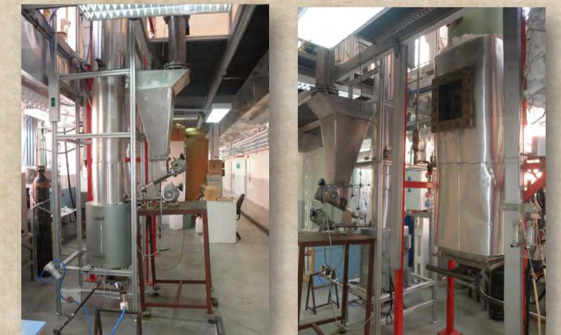
Gasificador de biomasa
